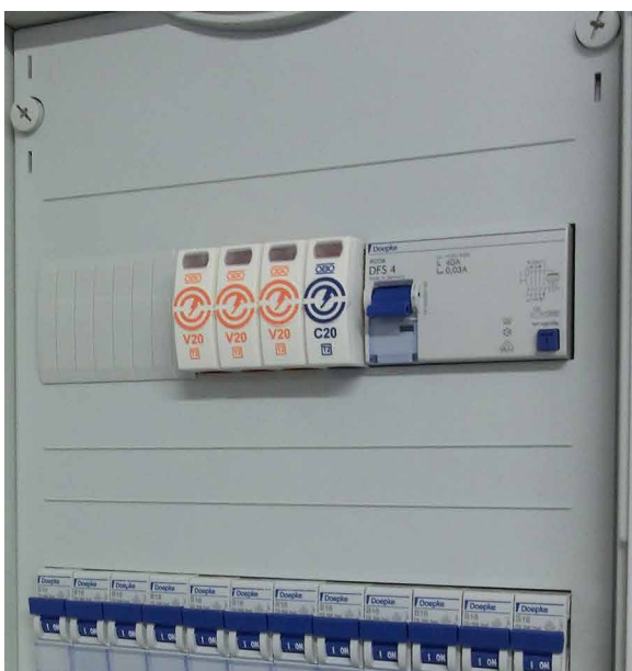
2 kép: 2. típusú túlfeszültség-védelmi eszköz, V20 3+NPE-280, elosztószekrényben
